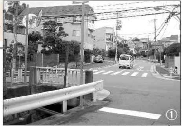
片側の親柱、欄干が無くなった久出ヶ谷橋
