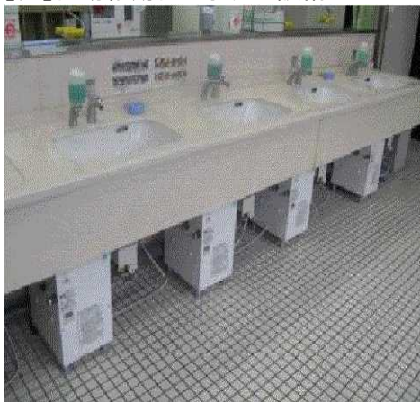
【例】自動給湯付き手洗い設備
