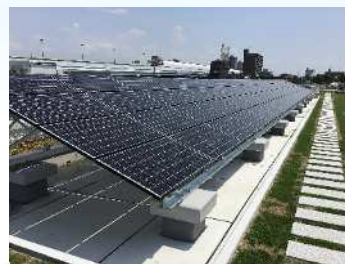
図 1-6 香楯園小学校の太陽光発電設備
