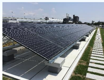
図 1-6 香榎園小学校の太陽光発電設備
