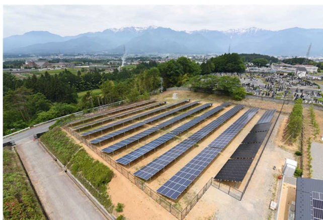
図表 56 リユース品を使用した発電所
