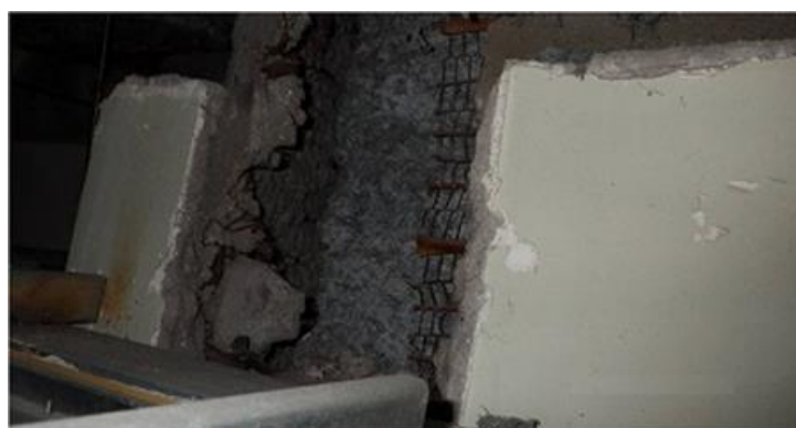
（参考資料）写真6－2 壁の中に青石綿が吹付けられた例
