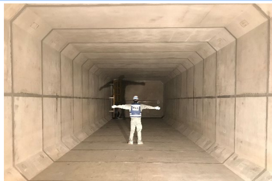
雨水貯留施設の整備（鳴尾駅前雨水調整池）
