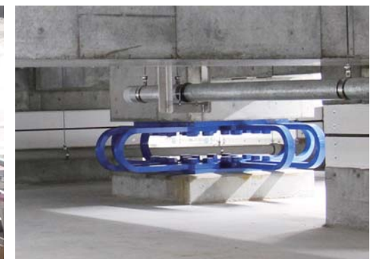
■免震層内の鋼材ダンパー (例)
