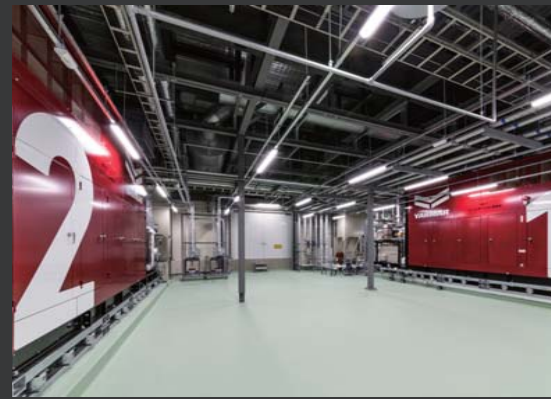
12階：非常兼用型コージェネレーションシステム
