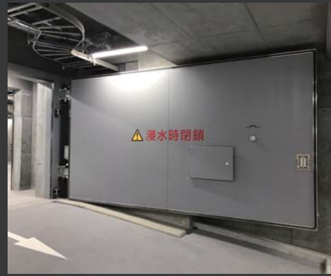
地下の浸水を防ぐ水密扉
