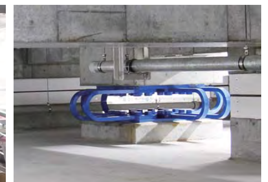
■免震層内の鋼材ダンパー (例)
