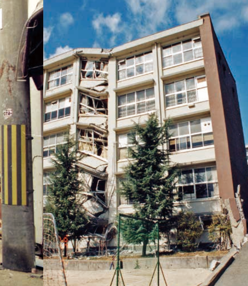
市立西宮高等学校／南校舎の1階から5階までの全階校舎の一部が陥没した様子
