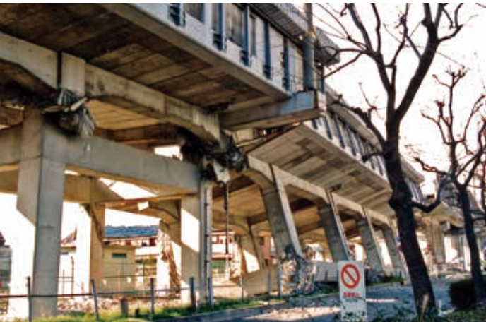
橋脚が崩れた山陽新幹線(上田市3丁目)
