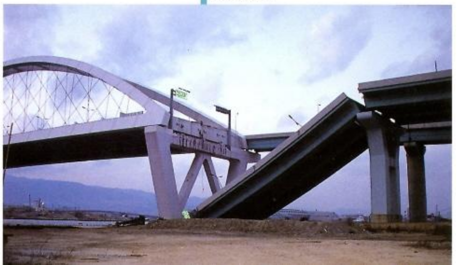
西宮浜を走る阪神高速道路湾岸線も大きな被害を受けた。
