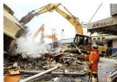
ホコリをたてないように、放水しながらの倒壊家屋の処理作業。
