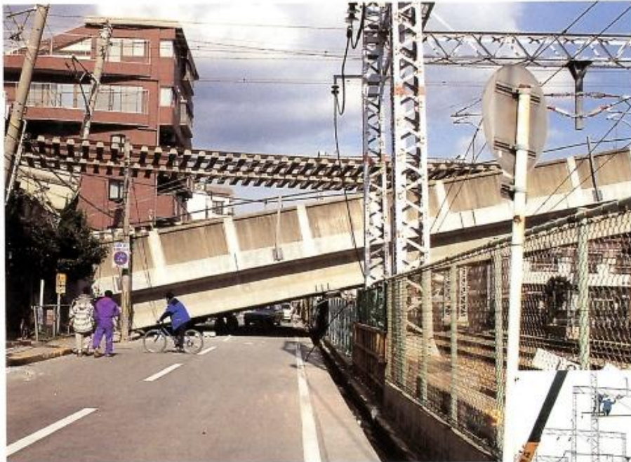
倒壊して道路をふさいでしまった山陽新幹線高架。 今回の地震では信じられない光景があらこちらでみられた。
