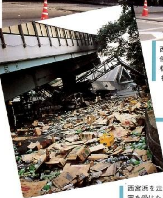
阪神高速道路の倒壊に巻き込まれたトラック。散乱したジュースの缶やペットボトル。(神戸線 本町付近)
