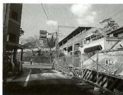
駅舎が損壊した阪急夙川駅。
