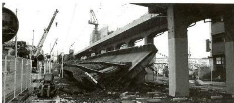
崩れ落ちた阪急電車の高架橋。
