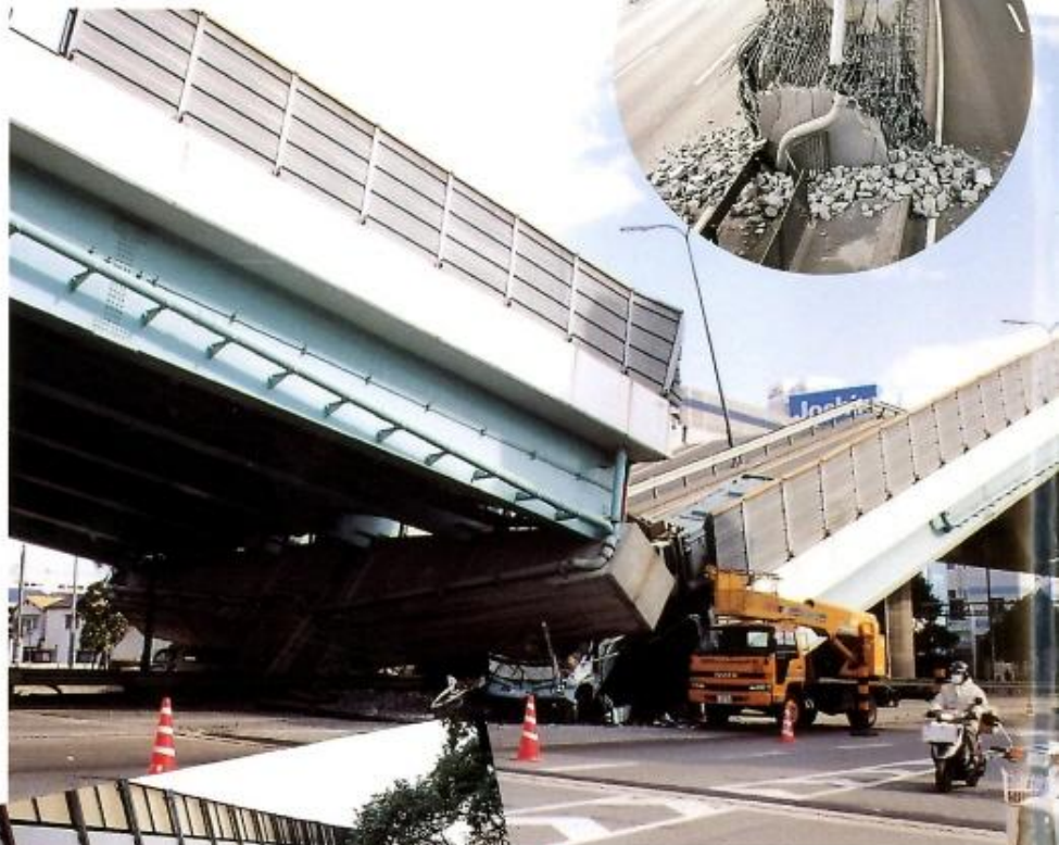
西宮市内の3カ所で阪神高速道路が倒壊。(神戸線 甲子園付近) 橋脚部分が無残に崩れ落ちた箇所も数多くみられる。(右上)
