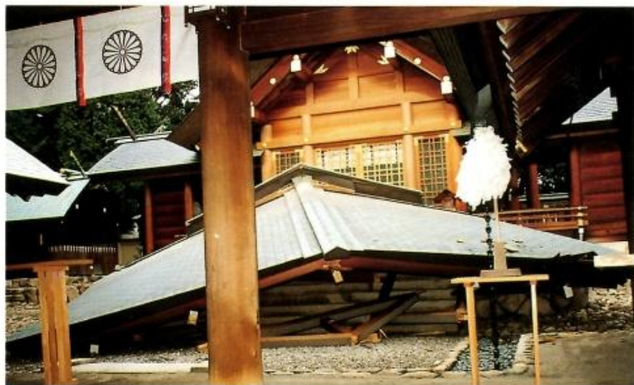
広田神社の社殿が崩壊。西宮市内の神社仏閣は大きな被害を受けた。
