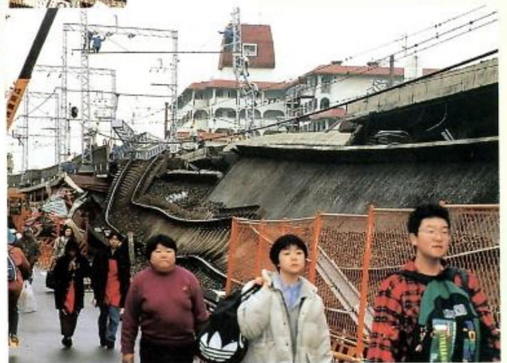
倒壊した阪急電車の線路沿いを歩く人々。阪急電鉄は夙川駅舎損壊、夙川～西宮北口間では高架橋部分が多数倒壊した。
