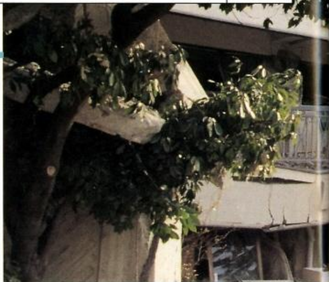
大手前女子大学の崩壊した校舎。
