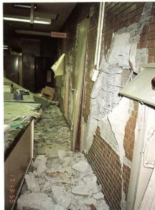
市役所本庁舎は6～8階が使用不能になるなどの大きな被害となった。内部では至る所が損壊している。
