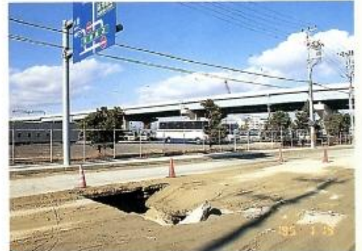
西宮浜や鳴尾浜など海に近い区域では液状化現象が起こり、大きな被害となった。
