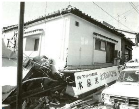
2階部分が完全に落ち、1階部分を押しつぶした。 (鴨尾町5丁目)
