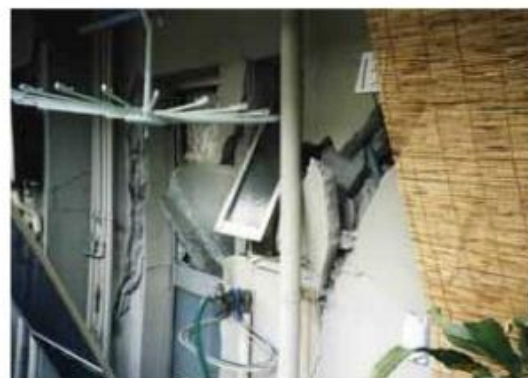
被災した市営住宅 上ヶ原四番町団地
