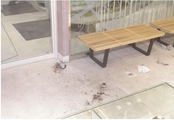
写真3-1 店舗内出火箇所の状況
