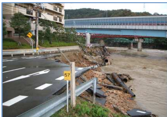
平成16年（旧国道176号） 台風23号・道路崩壊
