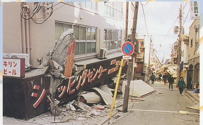
1階店舗が座屈した複合ビル（甲東園1丁目）
