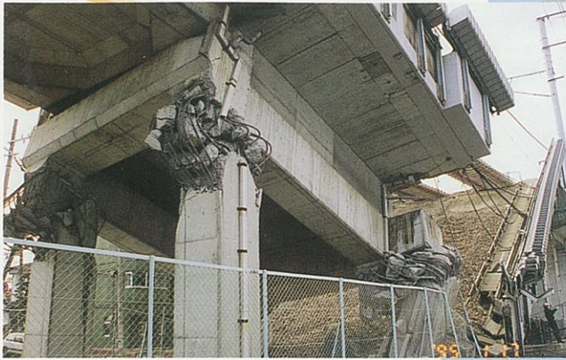
山陽新幹線高架の落下（上田市 1 丁目）
