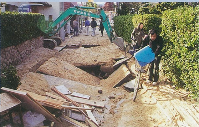
住宅街の暗渠が破壊され生活道路も使用不能となった （段上町 2 丁目）
