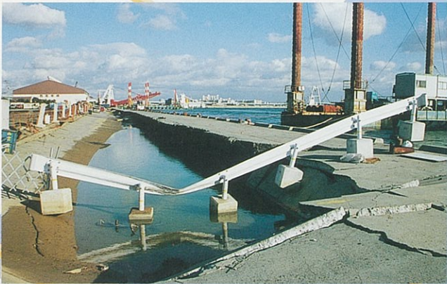
液状化による陥没した道路（西宮浜 2 丁目）
