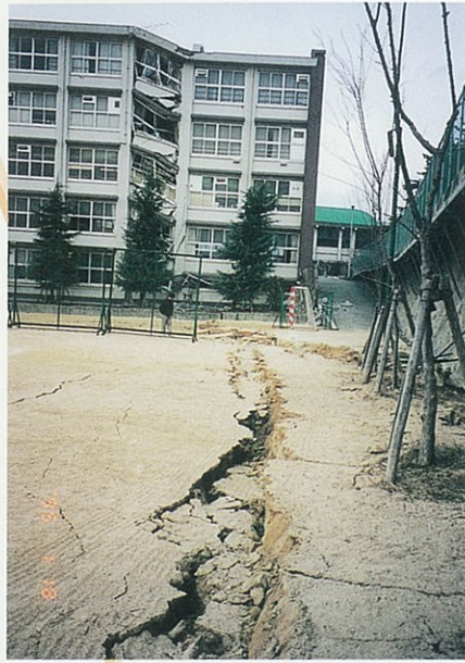
校舎グラウンドに地割れを生じ被害を受けた校舎 (高座町・市立西宮高等学校)
