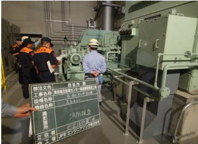
消防検査(少量危険物)(6月26日実施)
