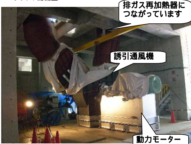
プラント補機室
