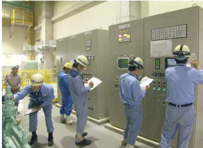
使用前自主検査(ボイラータービン総合負荷試験)
