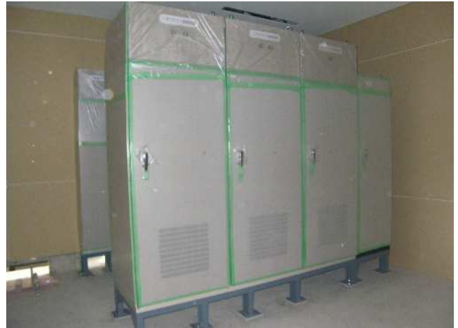
工場棟4階計装機器室
