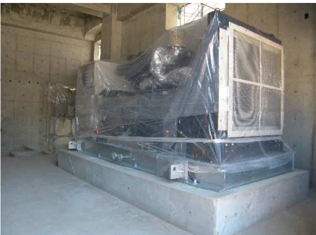
非常用発電機室
