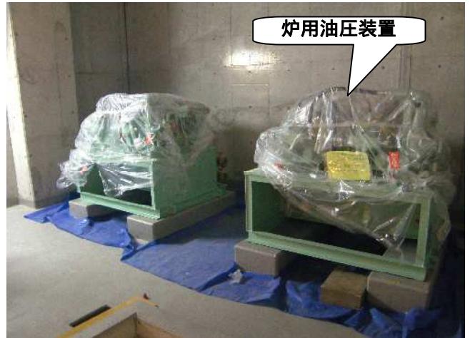
油圧ユニット室
