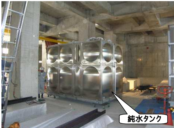
プラント補機室
