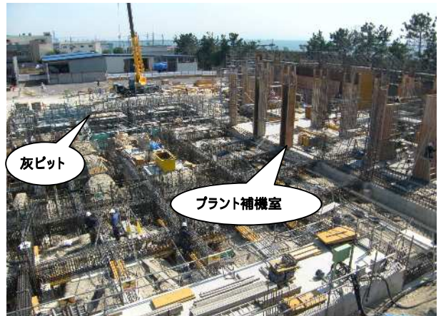
灰ピット、プラント補機室
