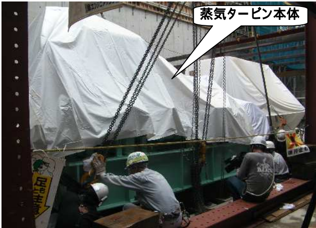
蒸気タービン発電機室
