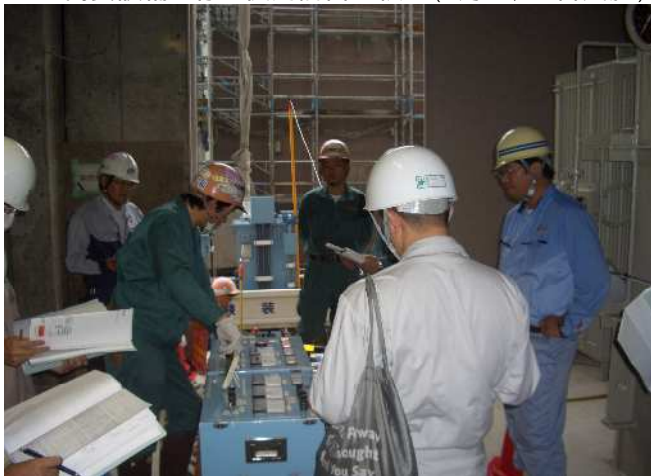
需要設備に係る使用前自主検査(6月19、20日実施)
