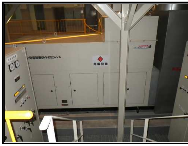
非常用発電機
