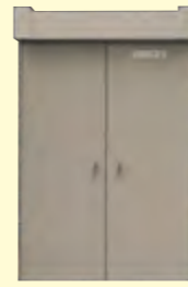
変圧器 電圧を210Vから6,600Vに昇圧
