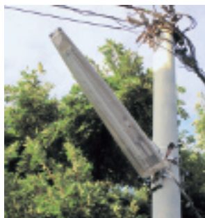
市内の防犯灯
