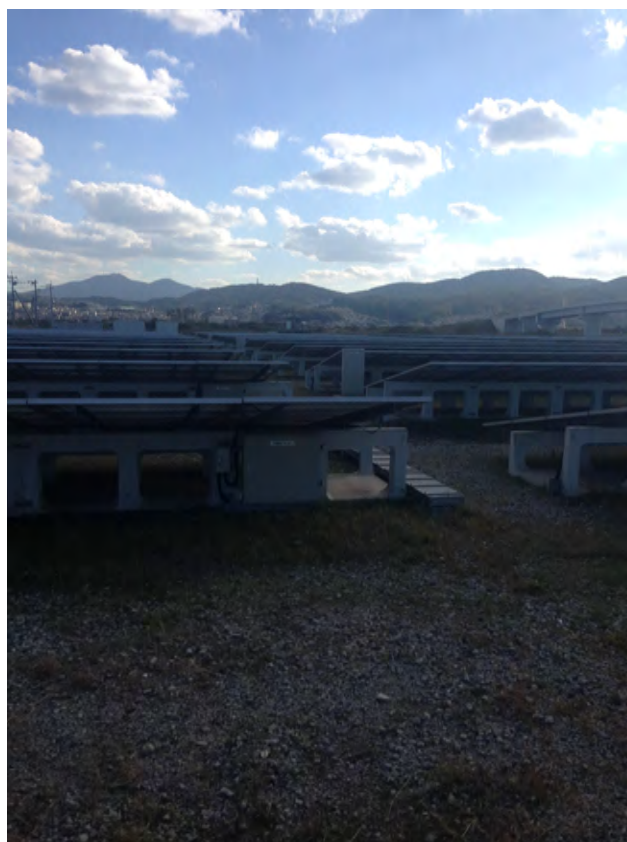
通常の太陽光パネルよりも発電量の大きなメガソーラー。
