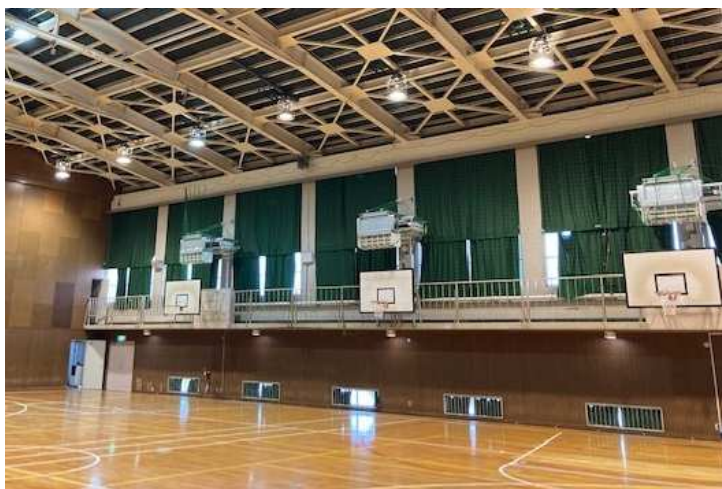
中学校に設置した体育館空調
