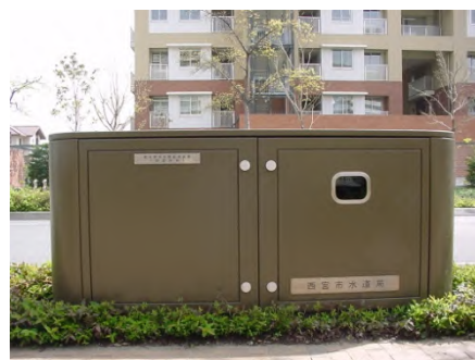
配水管末水質監視装置（西宮浜）
